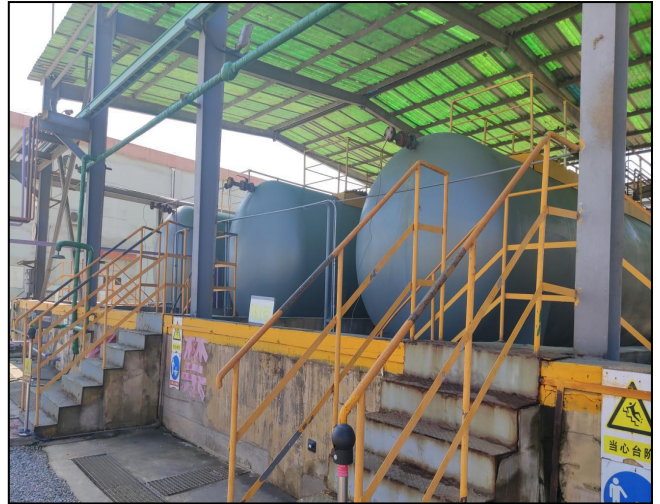
95m 3 四氯化硅储罐
